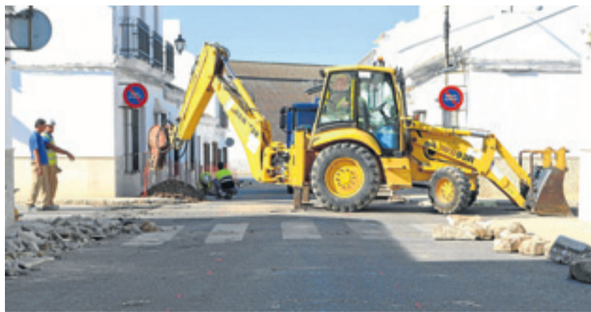
Los operarios trabajando en la zona con maquinaria pesada. / Ayuntamiento de Osuna
