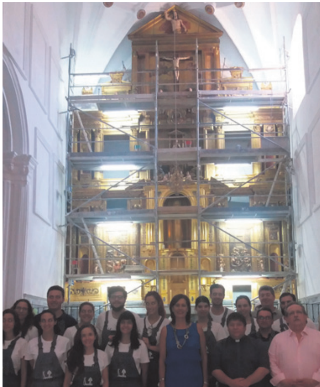
Visita al templo para comprobar el estado de las obras. / El Correo
