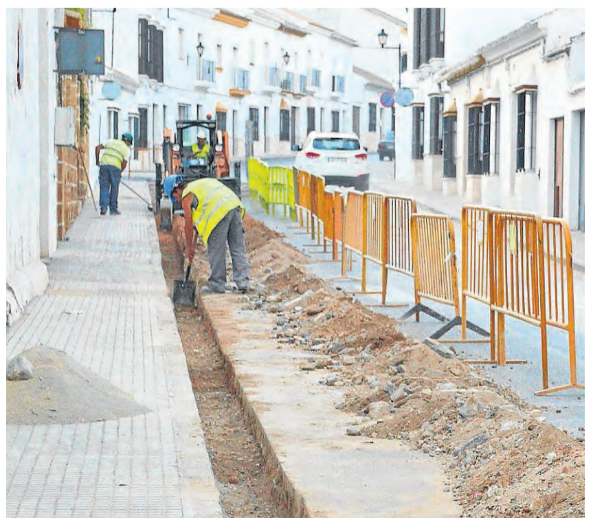
Los operarios, enfrascados en los trabajos de instalación del gas. / El Correo
